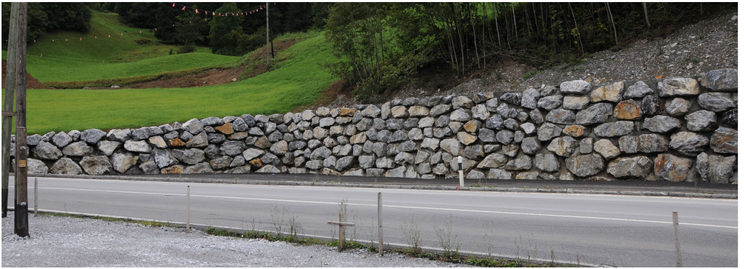
Mur de blocs formant un ouvrage de soutènement le long d'une route.
